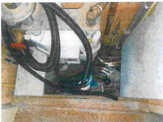
Figuur 15 Meterkast met pomp
