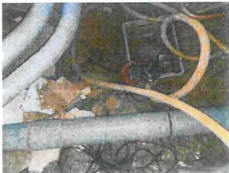
Figuur 11 Dompelpomp in de kruipruimte
