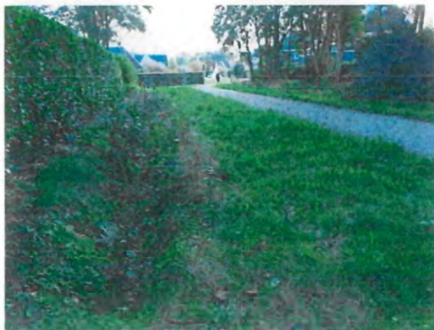
Figuur 13 Situatie achter het huis met naast de heg de gegraven greppel, in het midden het fietspad met daaronder drainage
