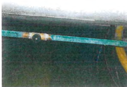
Figuur 7 Roestige buis kruipruimte
