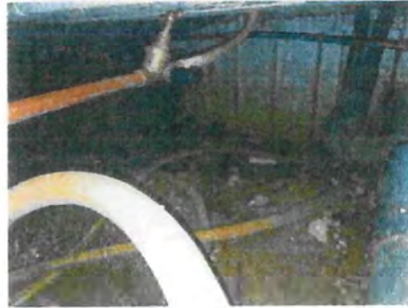
Figuur 12 Kruipruimte met sporen van water
