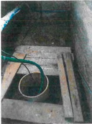
Figuur 22 Pomp in kruipruimte in overlooppuit
