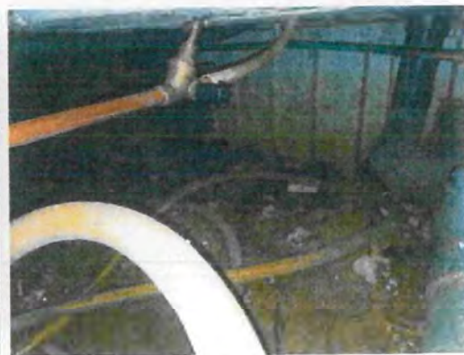
Sporen van water in de kruipruimte
