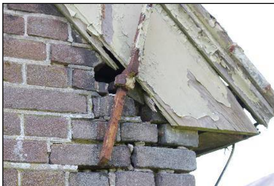
Afbeelding 2.5. Kieren en gaten in oude schuur.
