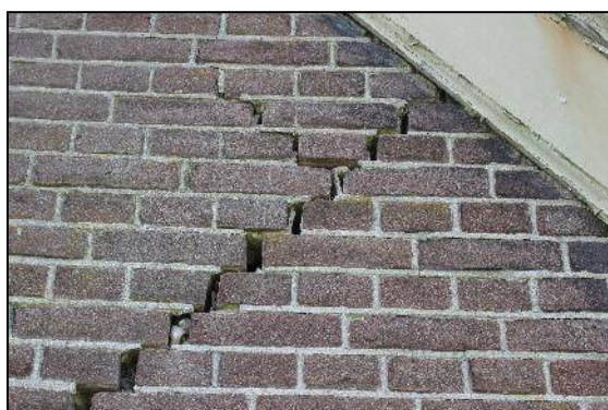
Afbeelding 2.6. Scheur in muur oude schuur
