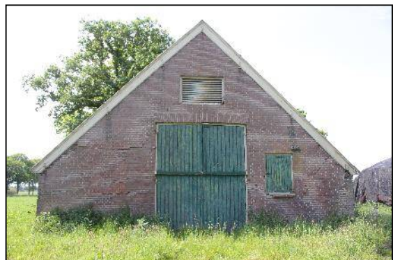
Afbeelding 2.3. De te slopen vervallen schuur oostzijde.
