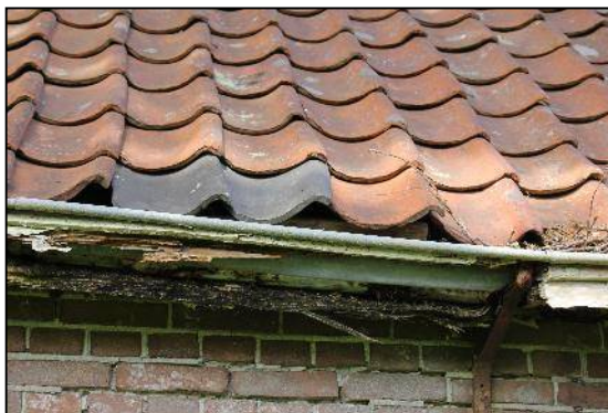
Afbeelding 2.9. Weggezakke regengoot oude schuur.
