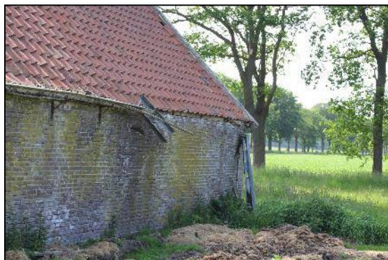
Afbeelding 2.8. Afgebroken regengoot oude schuur.
