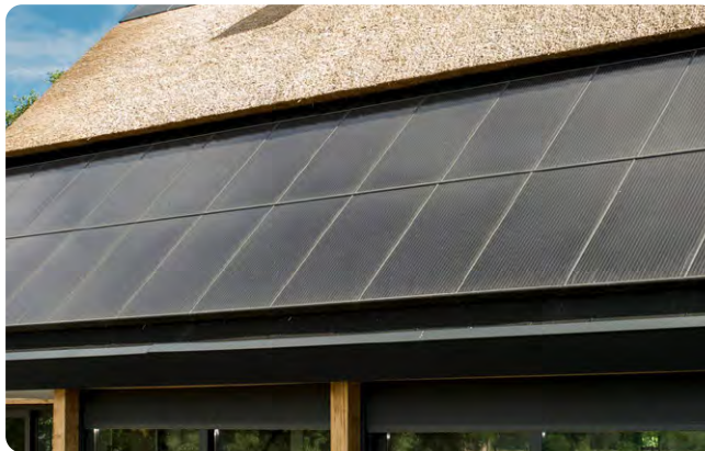
Donkere zonnepanelen geïntegreerd in dakvlak
