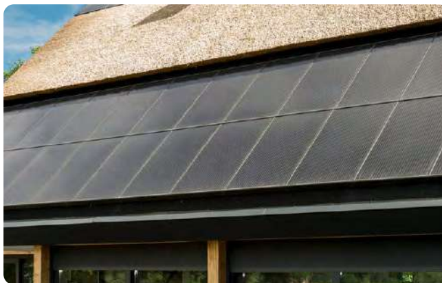
Donkere zonnepanelen geïntegreerd in dakvlak
